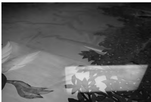
図4 修復前 シートの浮き上がり
