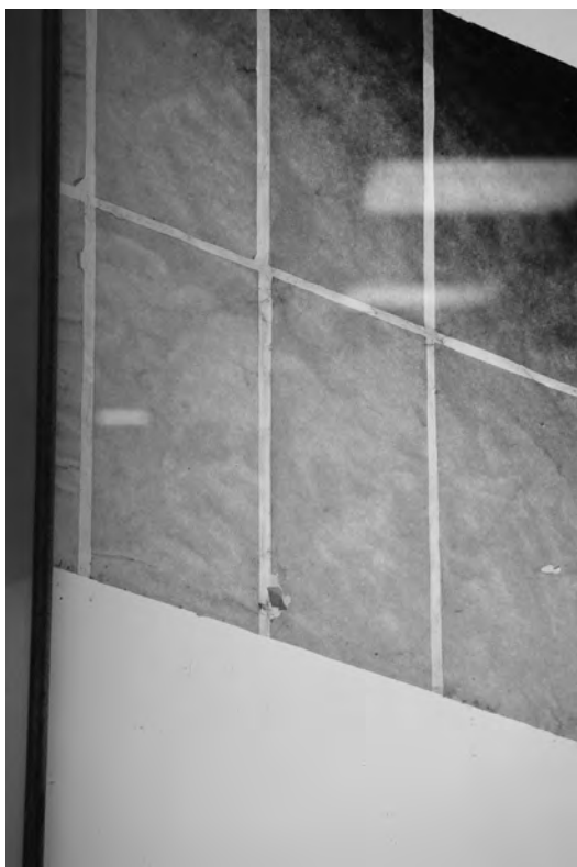
図3 修復前 左辺中央部 剥がれ、破れ、欠損
