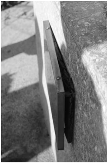
ユニコーン 1 銘板の脱落
